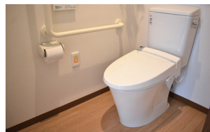
温水洗浄トイレ(ベストライフ柏中央)
