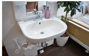
車いす対応洗面台
