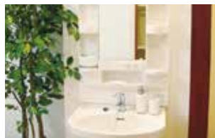
車いす対応洗面台
