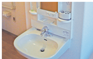
車いす対応洗面台
