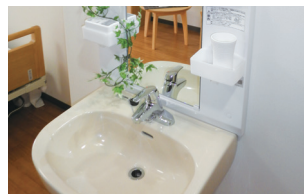
車いす対応洗面台
