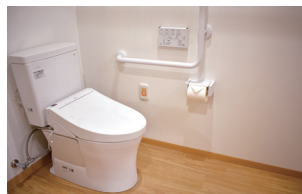
温水洗浄トイレ (ベストライフ東松山Ⅱ)
