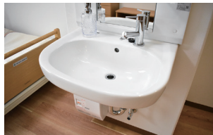
車いす対応洗面台
