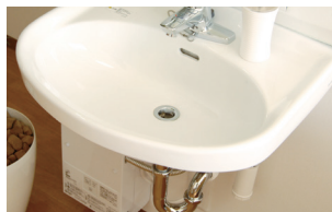
車いす対応洗面台
