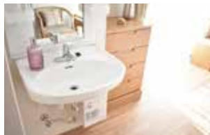
車いす対応洗面台
