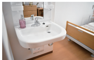
車いす対応洗面台
