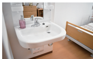
車いす対応洗面台
