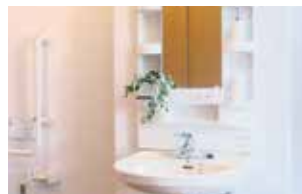
車いす対応洗面台
