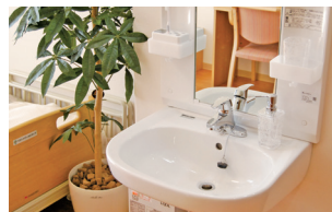
車いす対応洗面台
