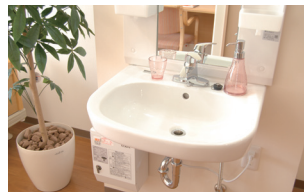
車いす対応洗面台
