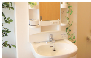
車いす対応洗面台
