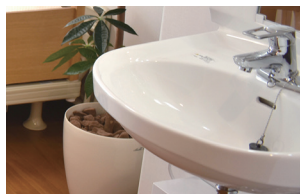
車いす対応洗面台
