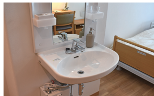
車いす対応洗面台
