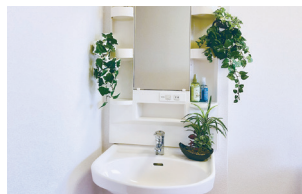
車いす対応洗面台
