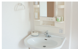
車いす対応洗面台
