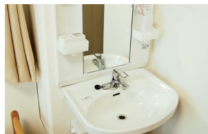
車いす対応洗面台
