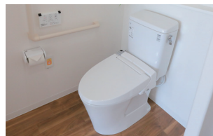
温水洗浄トイレ(ベストライフ手稲)
