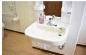
車いす対応洗面台(ベストライフ武蔵藤沢)
