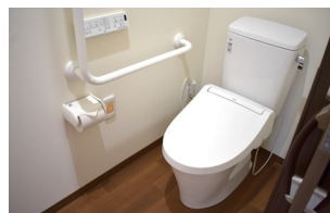
温水洗浄トイレ (ベストライフ小平南)
