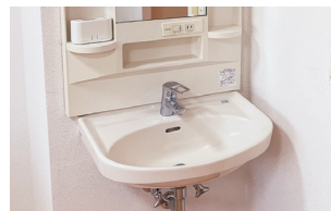
車いす対応洗面台(ベストライフ小岩)
