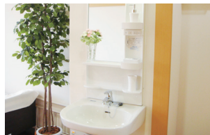
車いす対応洗面台
