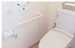
温水洗浄トイレ(ベストライフ京都)
