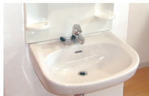
車いす対応洗面台
