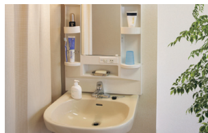
車いす対応洗面台(ベストライフ溝の口)
