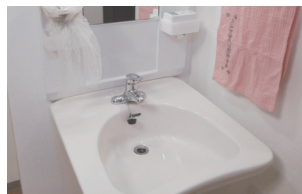
車いす対応洗面台
