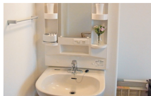
車いす対応洗面台
