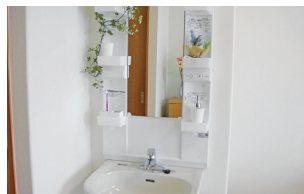
車いす対応洗面台
