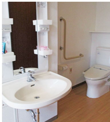
車いす対応洗面台・温水洗浄トイレ(ベストライフ西東京松の木)
