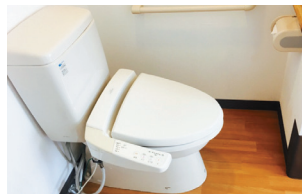
暖房便座トイレ(ベストライフ国立)
