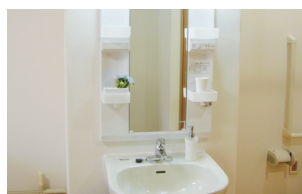
車いす対応洗面台
