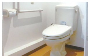
暖房便座トイレ(ベストライフ宮前平)
